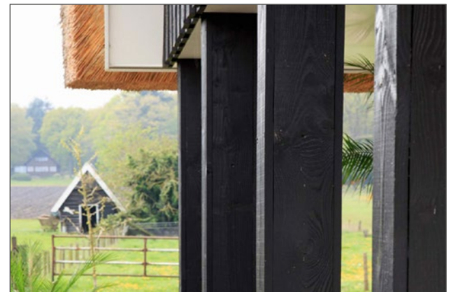
hout in gevelwerk
