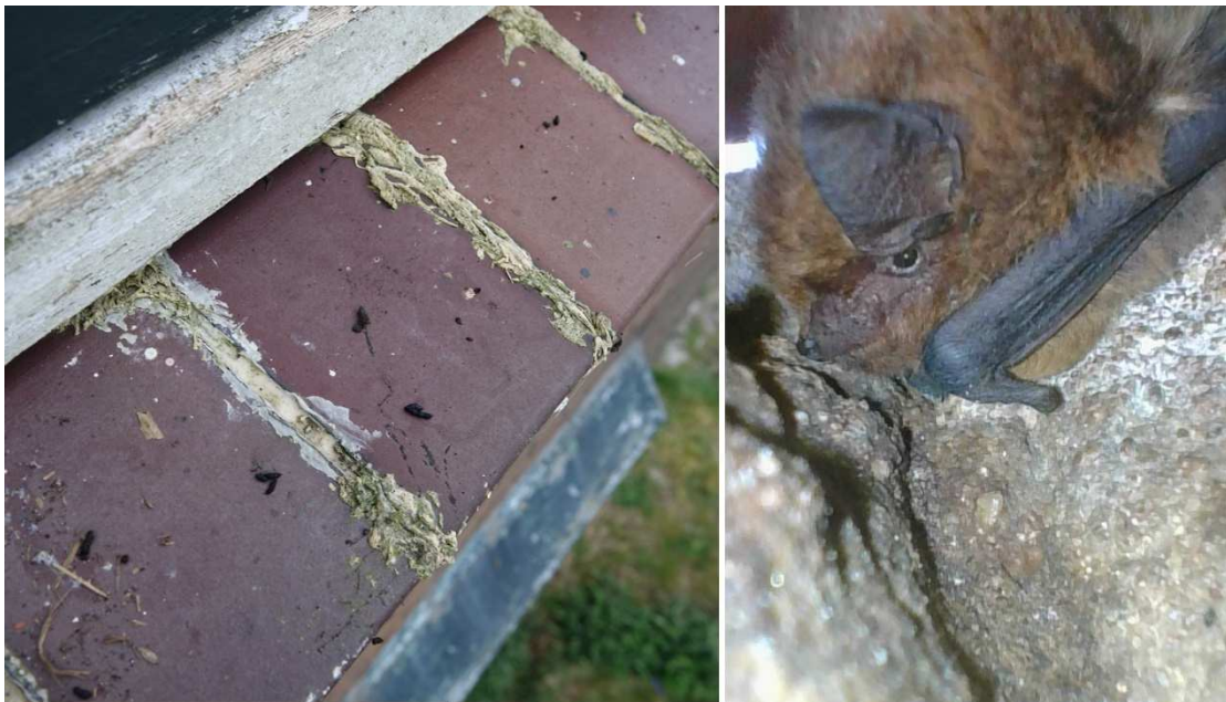
Figuur 4. Verse uitwerpselen op vensterbank en (ruige) dwergvleermuis onder kantpan van de woning aan de Tropweere 16 te De Weere.
