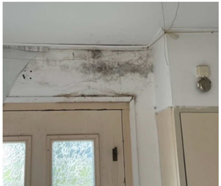
Vochtdoorslag voorgevel (westzijde)
