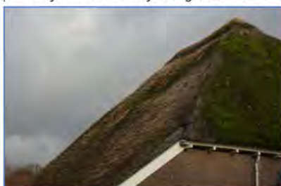
Foto 19 slechte staat rieten kap west
