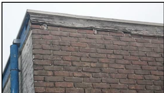
Afbeelding 2: Ruimtes onder houten dakranden
