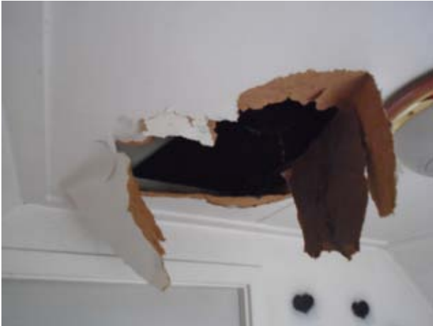
Noordeinde 65, weggetrokken plafond zolderkamer
