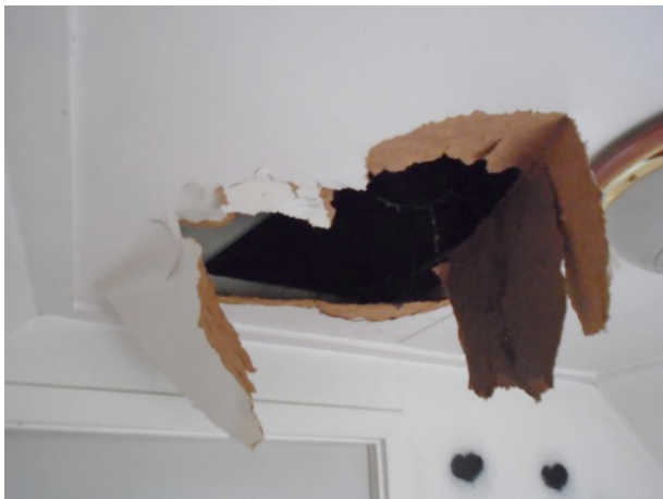
Noordeinde 65, weggetrokken plafond zolderkamer
