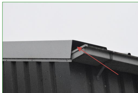
Kier in dakrand van bestaand gebouw.
