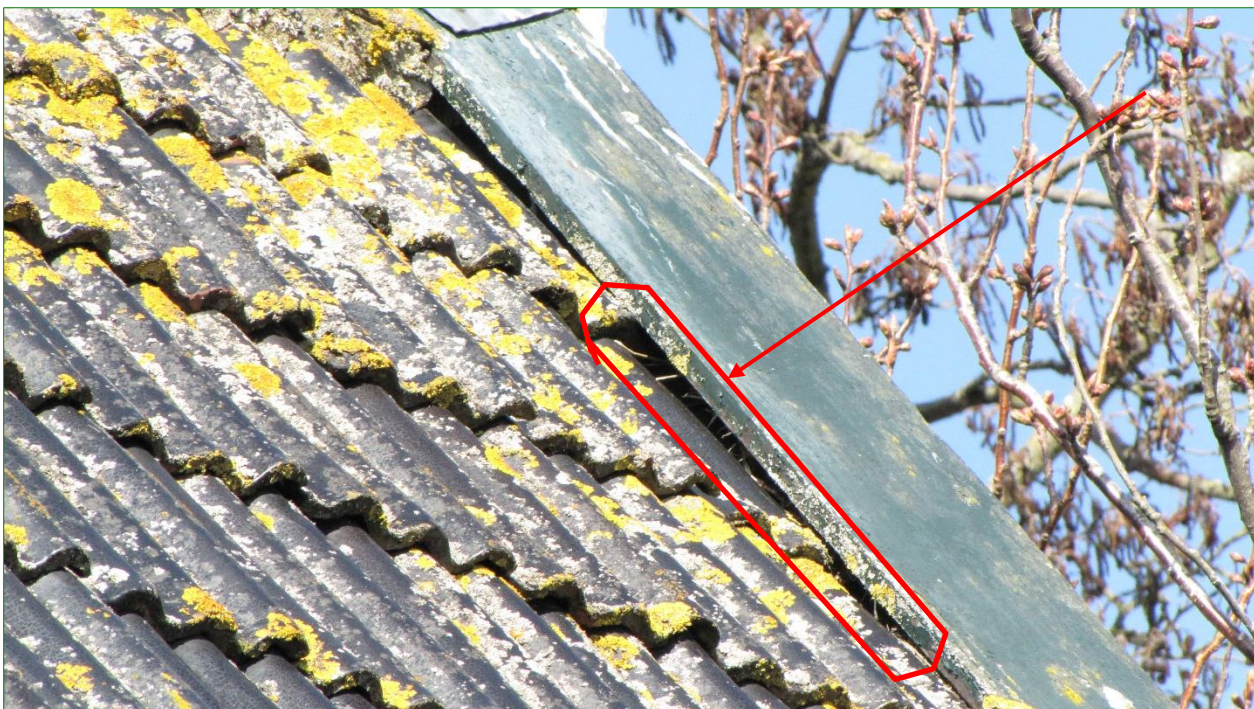
Strootjes onder de houtbetimmering van het woonhuis.
