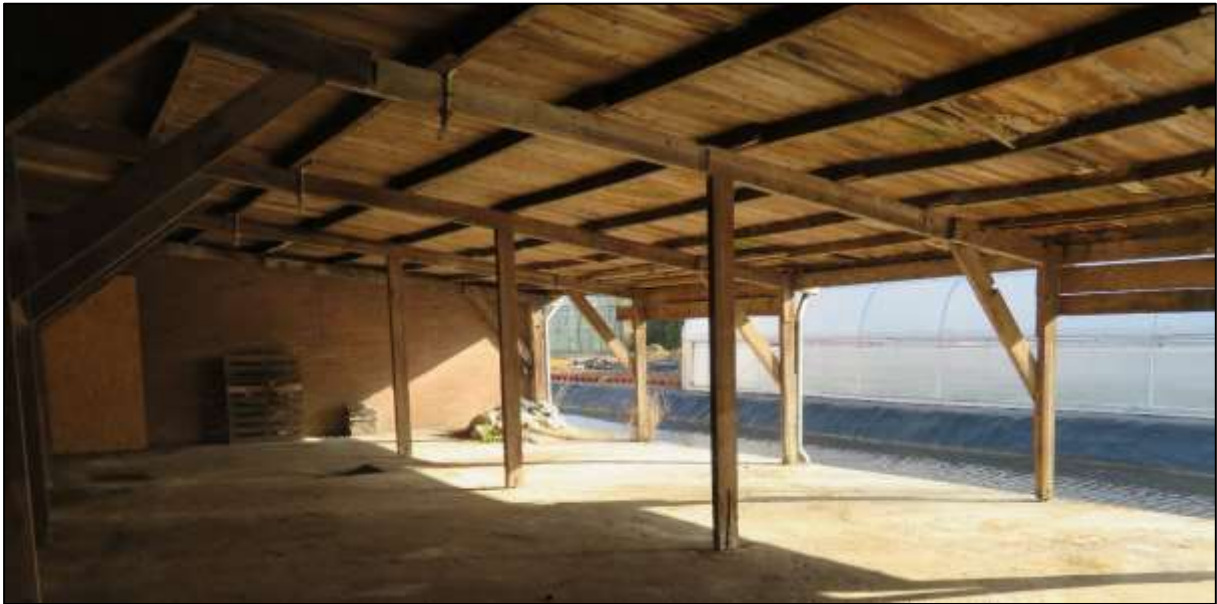
Afb 11: Geen nesten op de spanten/balken onder de overkapping
