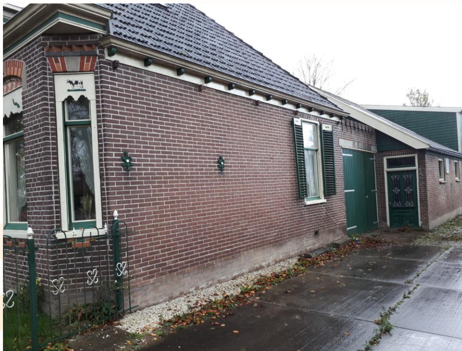
FOTO 3: scheurvorming in rechterzijgevel (rechter onder hoek raam)
