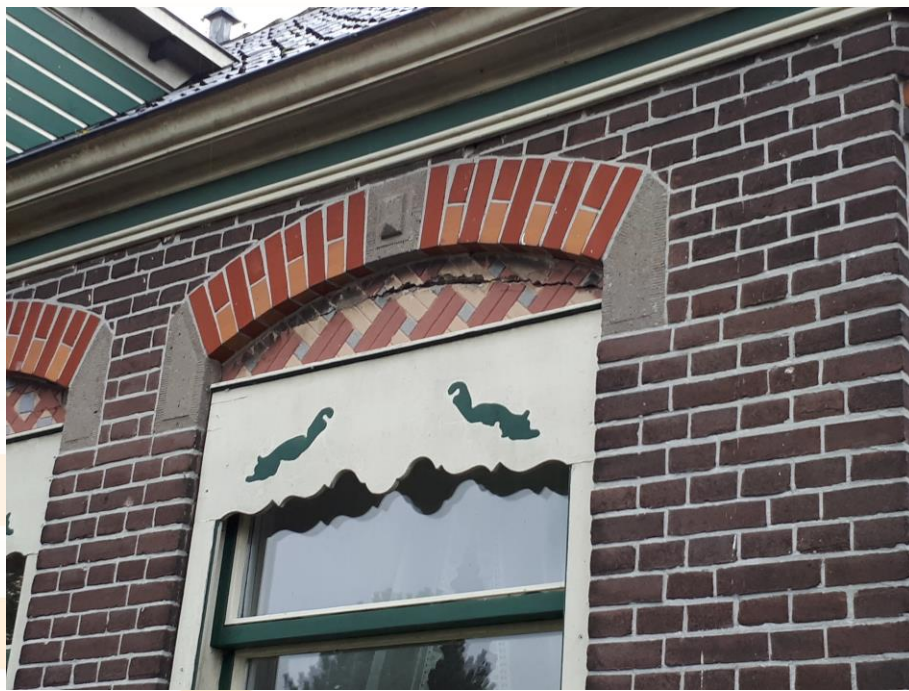
FOTO 4: losliggende rollagen t.p.v. ramen in voorgevel
