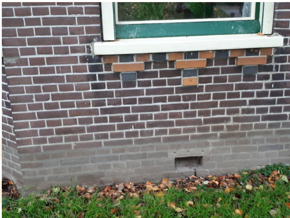
FOTO 2: provisorisch herstelde scheur in voorgevel
