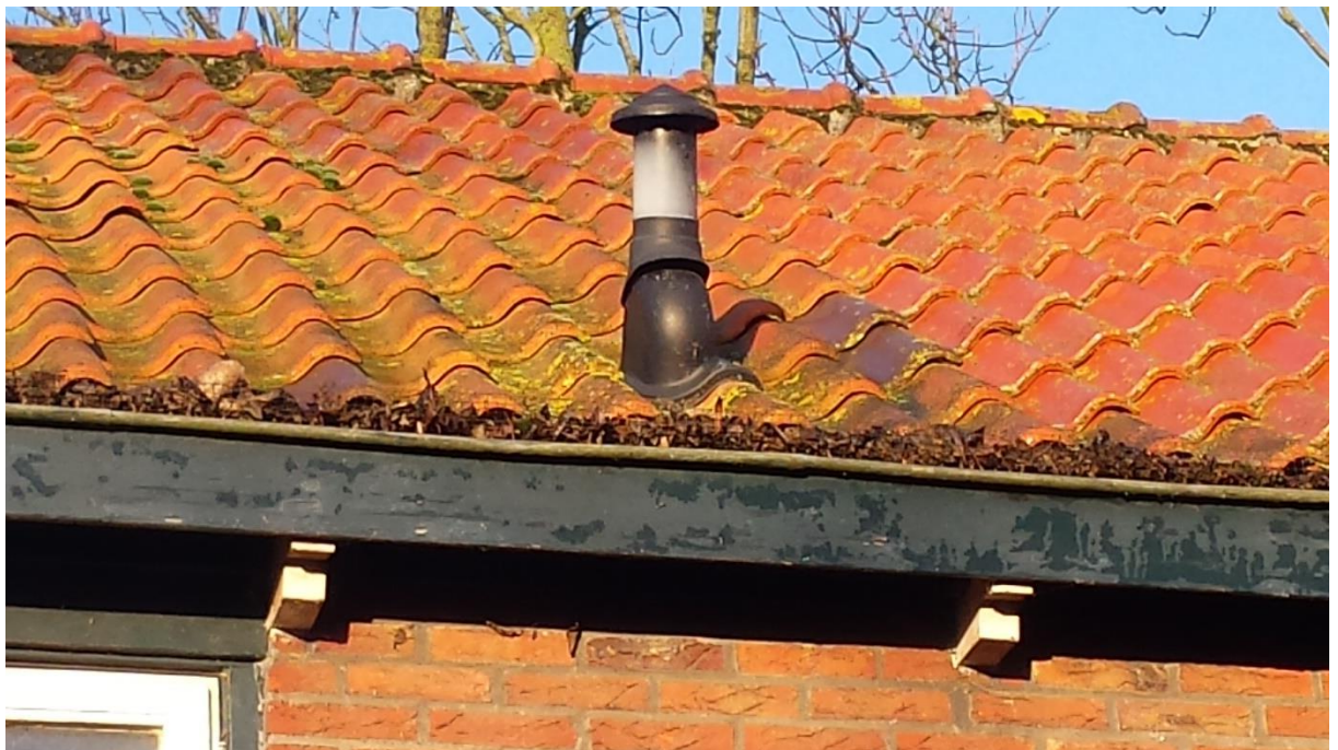
De aangesloten dakpannen met vogelschroot bieden geen nestgelegenheid voor de Huismus en Gierzwaluw
