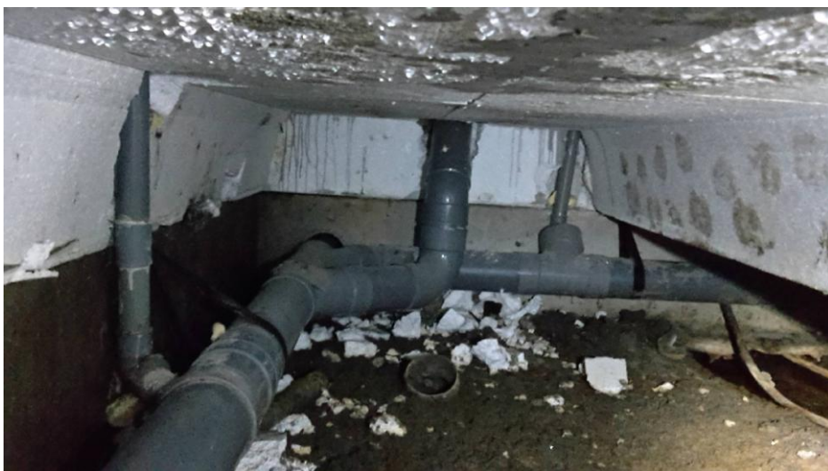
Overzicht kruipruimte, vocht hoopt op aan de onderzijde van de vloerbalk
