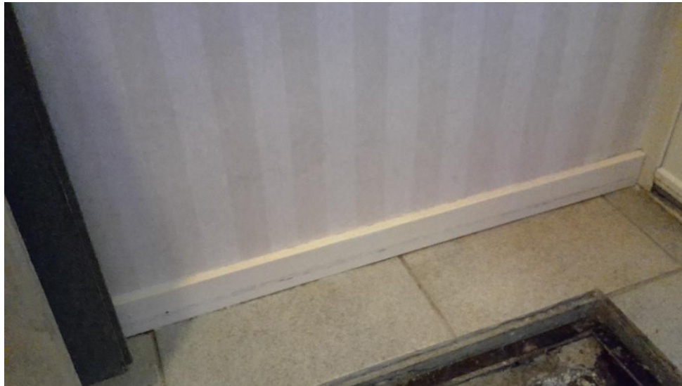
Vlekken in behang door optrekkend vocht
