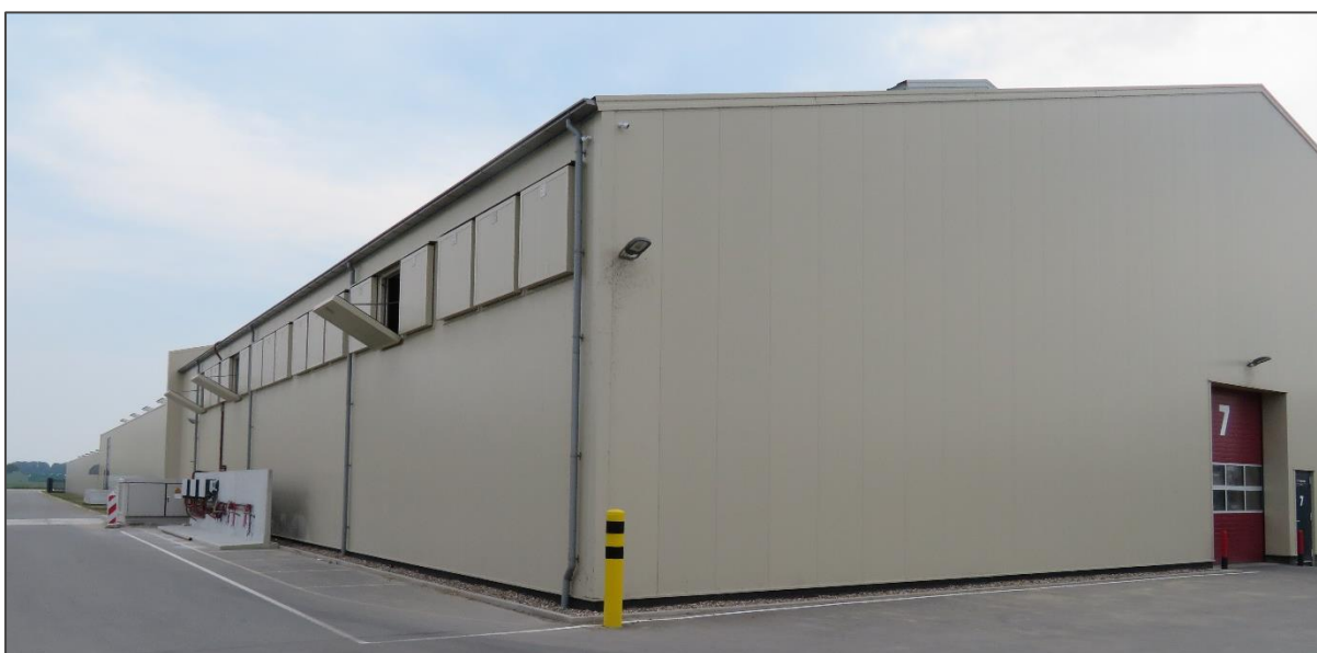
Afb 10: Strakke aansluitingen van sandwichpanelen. Maar ook ventilatieluiken waardoor vogels wel naar binnen kunnen.
