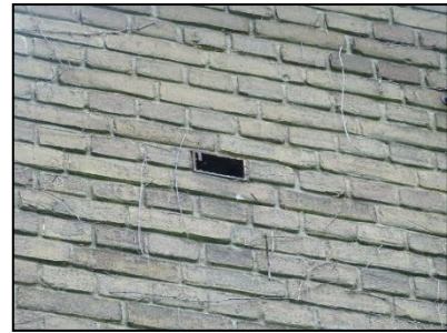
Figuur 23. Één gevelventilatie-opening mist het ventilatierooster. Deze opening bevindt zich op de hoogte van de eerste verdieping aan de westelijke gevel.
