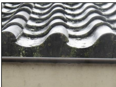
Figuur 10. Eindpannen bieden geen toegang tot de ruimte onder de dakpannen.
