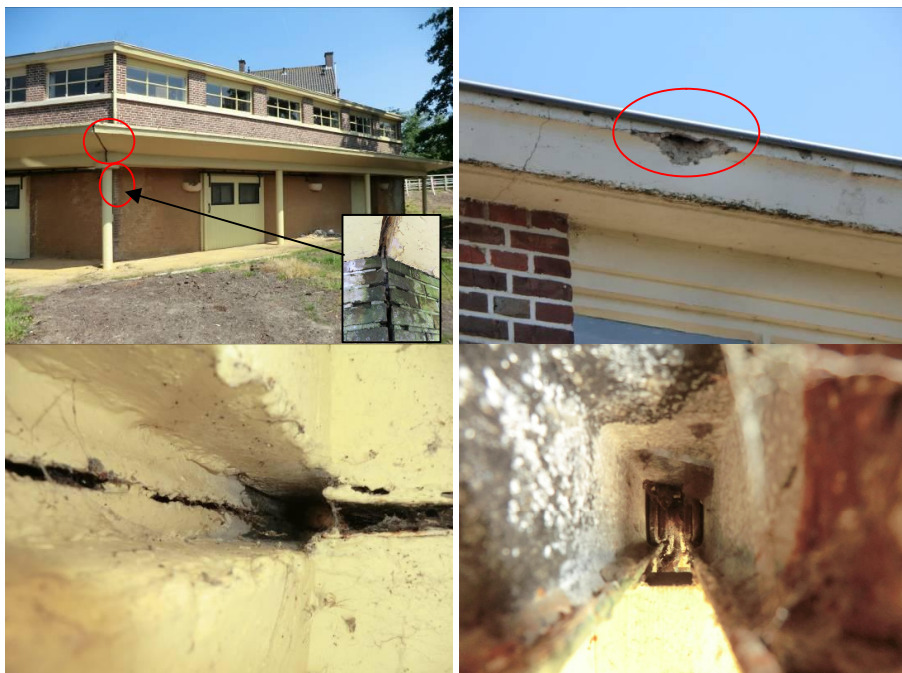
Figuur 3.4.3a, scheuren in achtergebouw
