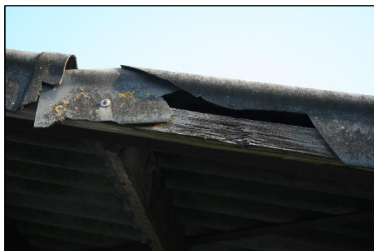
Figuur 4: Ruimtes tussen asbestplaten en dakranden
