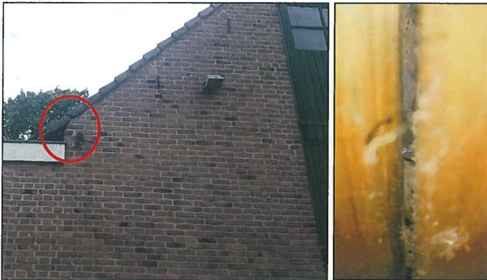
Afbeelding 4: Pannendak met mogelijke invliegopeningen (rode cirkel) en ruimte tussen de dakbetimmering en de dakpannen.
