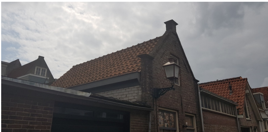
afb.24 Recht pannendak, geen kapotte pannen, geen openingen in dakrand
