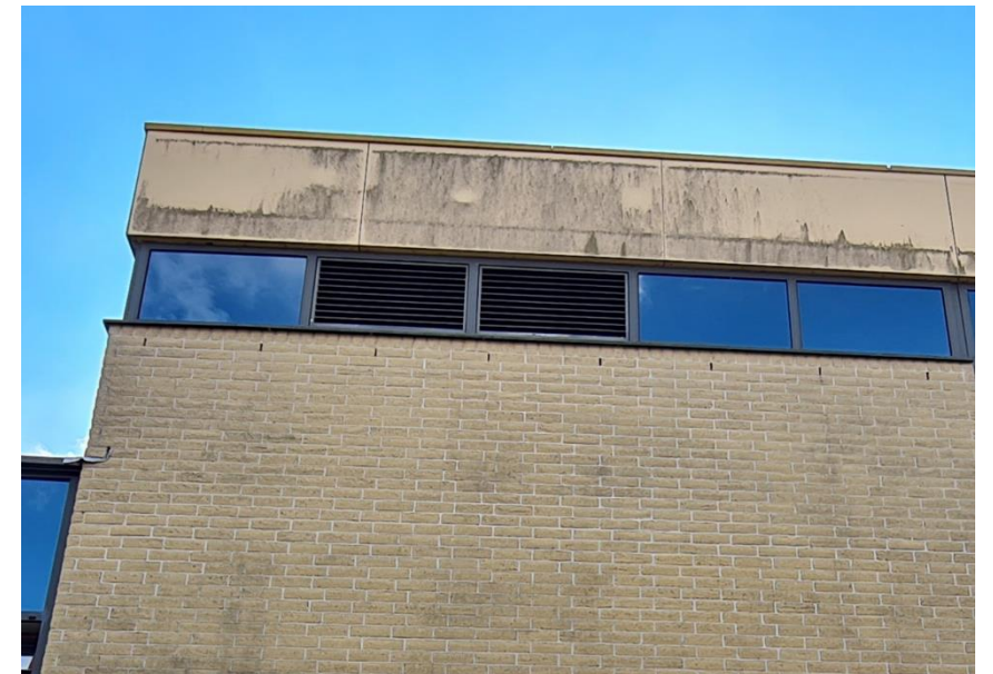
Figuur 10: Open stootvoegen bij een van de muren van het gebouw binnen plangebied
