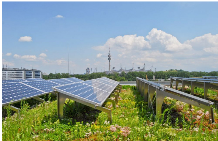
zonnepanelen op een plat dak in combinatie met een groendak
