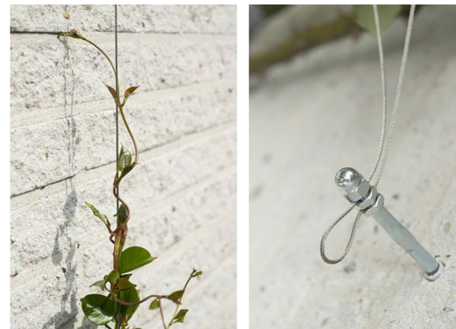
Klimplant slingert om het klimsysteem heen en hecht zich niet aan de gevel
