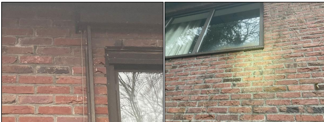
Figuur 6.3 (links) en 6.4 (rechts): Het gebouw aan de noordzijde van het perceel vertoont kieren en gaten, geschikt voor vleermuizen, rond de ramen en daklijst.
