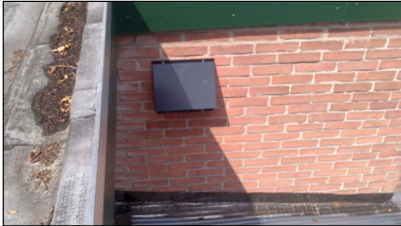
Foto 4.2: Afvoer van ruimtelucht (horizontale afvoer en voorzien van klep)
