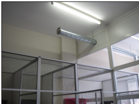
Foto 3.2: Kanalen ten behoeve van ruimteafzuiging
