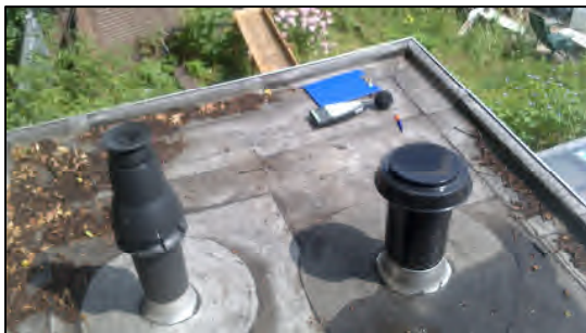
Afbeelding 3.7 Rookgasafvoer (links) en Afzuiging technische ruimte (rechts)
