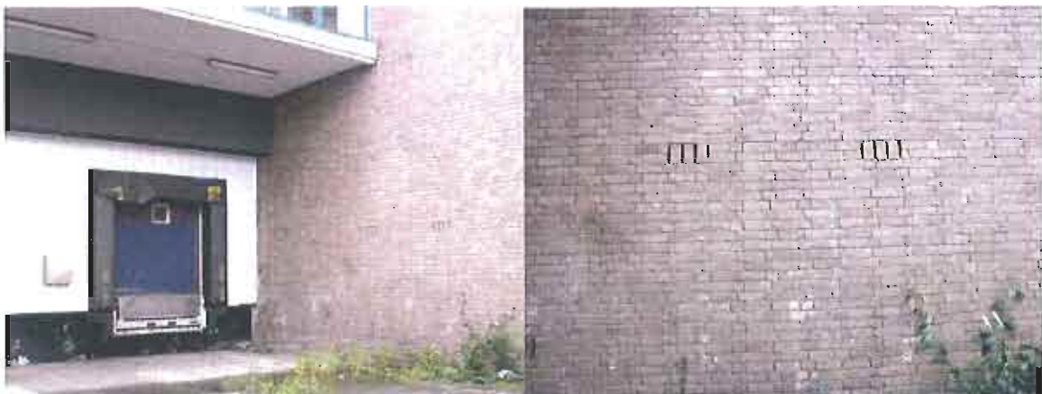
Fig. 4: Ontluchtingsroosters in de spouwmuur.
