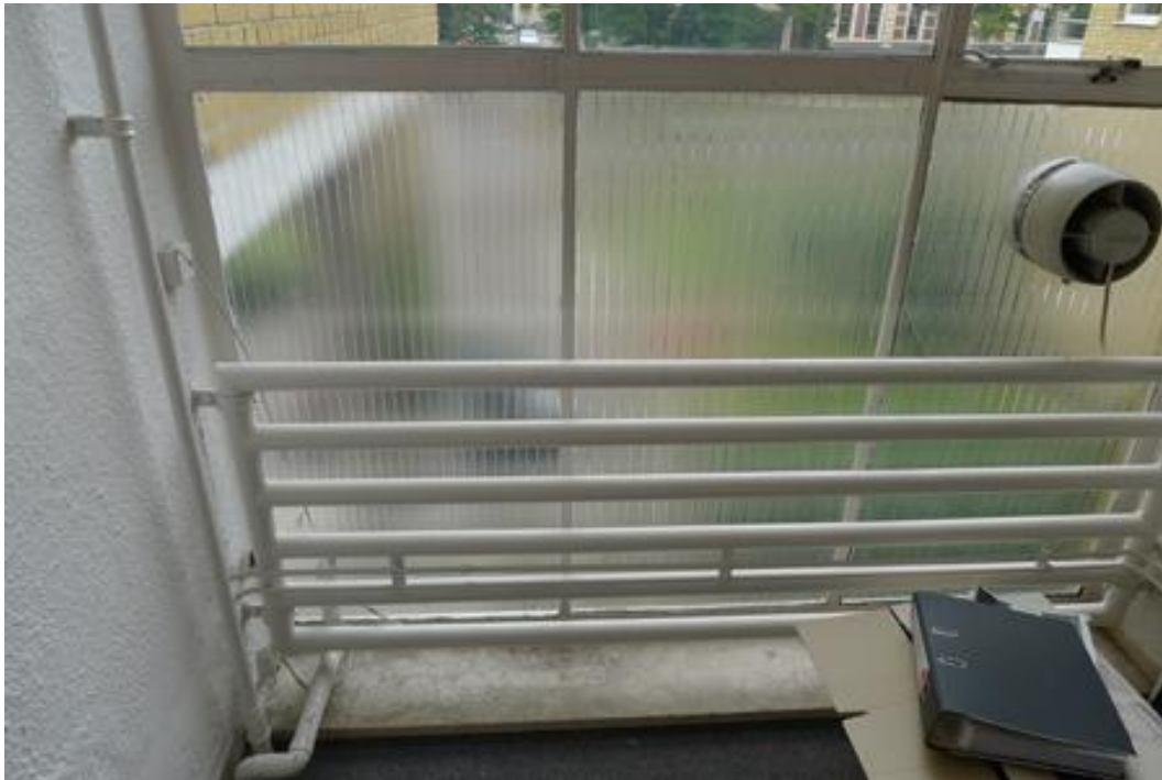
Verwarmingselement uit de bouwtijd van stalen buizen bij de glazen pui van een van de voormalige trappenhuizen aan de westzijde.
