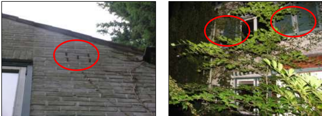
Locaties waar mogelijk een verblijfplaats van vleermuizen aanwezig kan zijn. Op de linker foto zijn open stootvoegen te zien waarachter mogelijk een verblijfplaats in de spouwmuur aanwezig is. Rechts zijn raamluiken omcirkeld waarachter een zomerverblijfplaats aanwezig kan zijn. Foto's SAB (2014).
