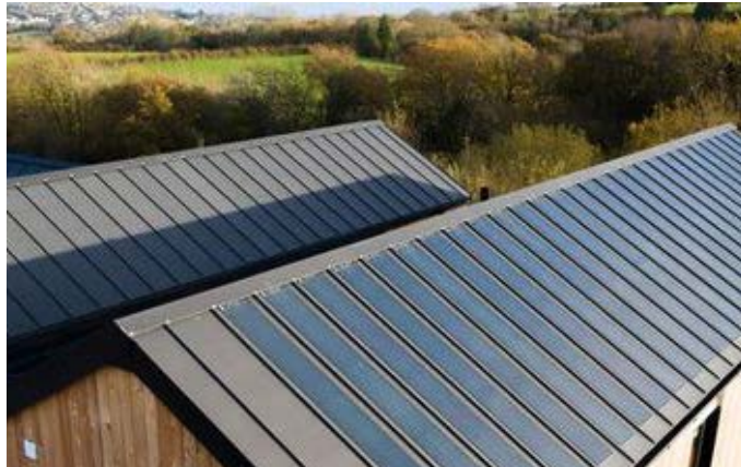
zonnepanelen in het dakvlak
