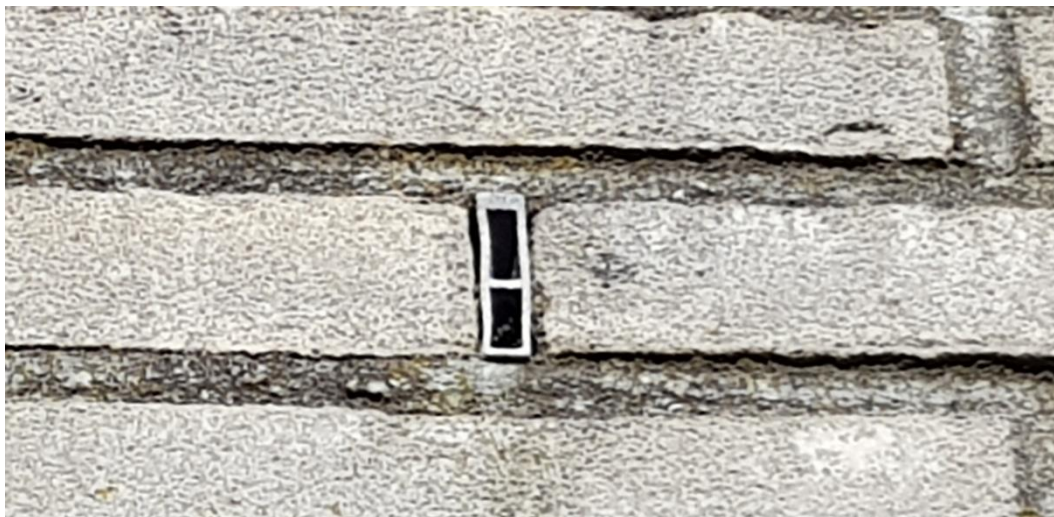
Afbeelding 9. Het kantoorgebouw is ontoegankelijk voor vleermuizen door o.a. de aanwezigheid van rasters in de open stootvoegen.
