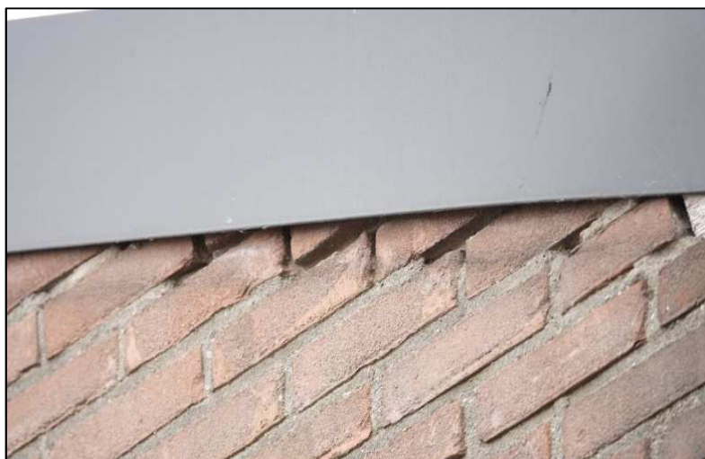
Missende voegen geven inkruipmogelijkheden voor vleermuizen.
