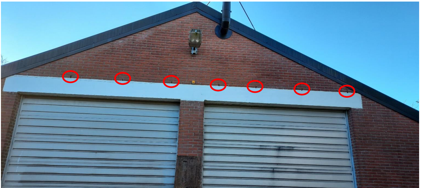
Figuur 24: Open stootvoegen waardoor gebouwbewonende vleermuizen toegang hebben tot de schuur.
