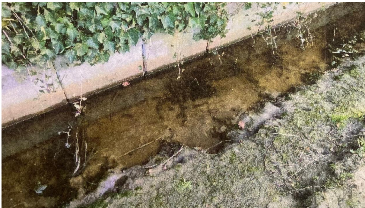
Figuur 7: Onder: De vurg op de noordelijke perceelsgrens. De betonnen beschoeiing is van het perceel aan de Runxputteweg 34
