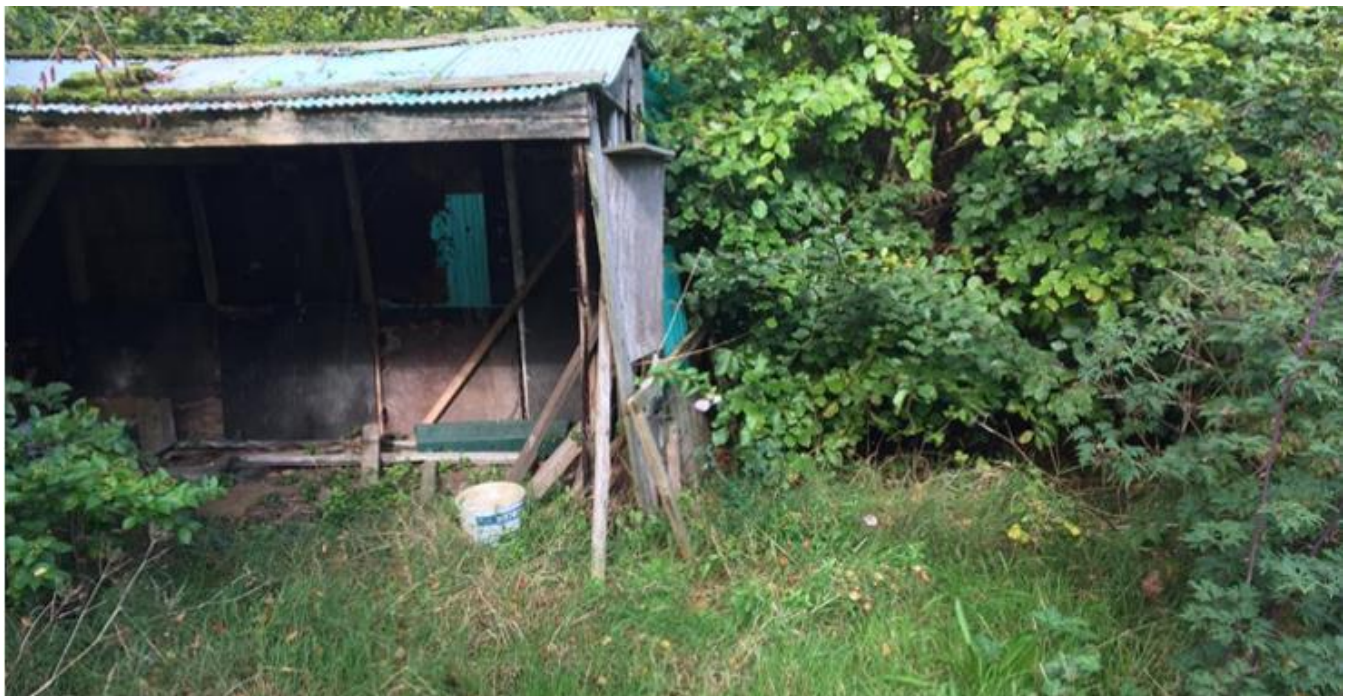
Figuur 7. Een vervallen opstal binnen het plangebied. Door open structuur ongeschikt voor beschermde soorten.
