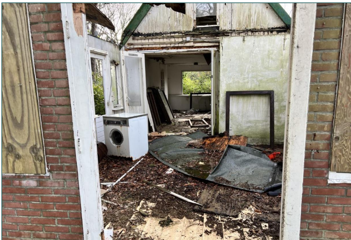
Figuur 3 De te slopen woning verkeert in een ernstige staat van verval.
