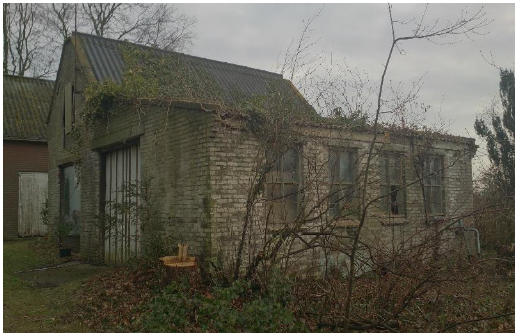
Figuur 2 De achterzijde van de schuur, welke is opgetrokken uit gemetselde muren en een golfplaten dak, is sterk begroeid met klimplanten.
