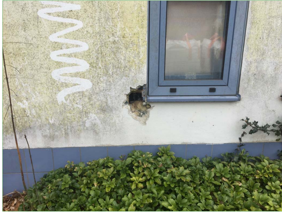
Gat in de muur, laag bij de grond.
