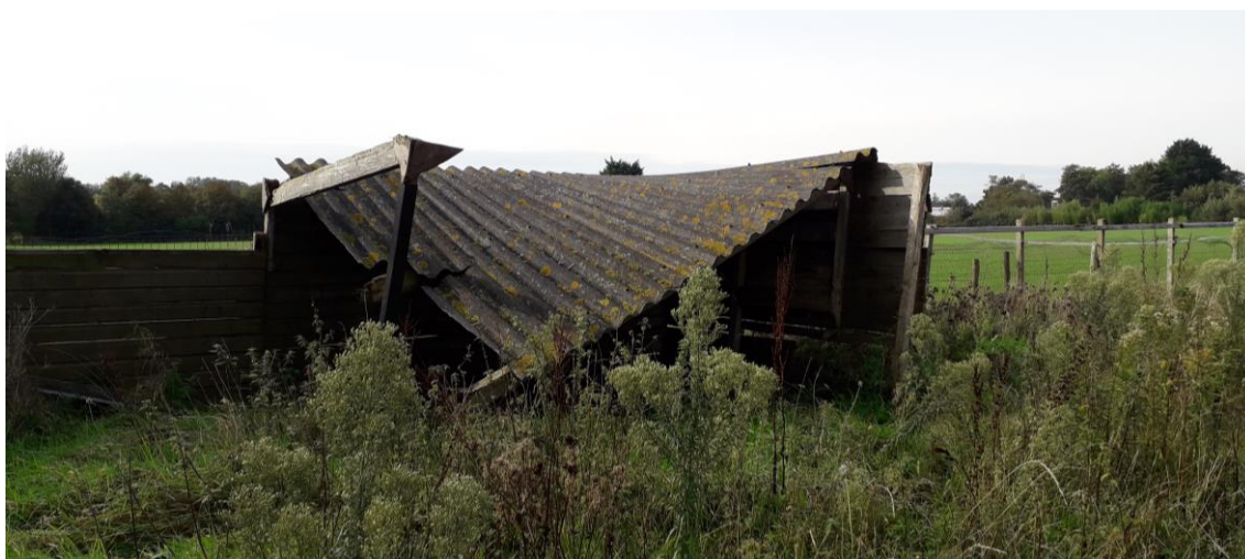
Figuur 3: Asbestverdachte schuur op perceel 2195
