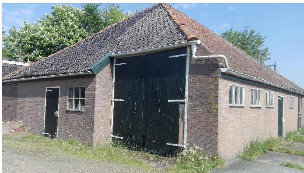
Figuur 2 Schuur 3 bevat veel openingen en toegangen voor vleermuizen. Tevens is er geen isolatie aanwezig tussen de pannen en het rieten dak aan de binnenzijde.
