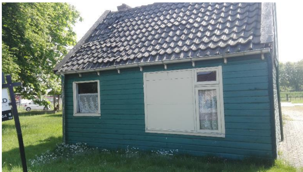
Figuur 1 Schuur 2 bevat veel openingen, kapotte dakpannen en gaten die geschikt zijn voor gebouw-bewonende vleermuizen.
