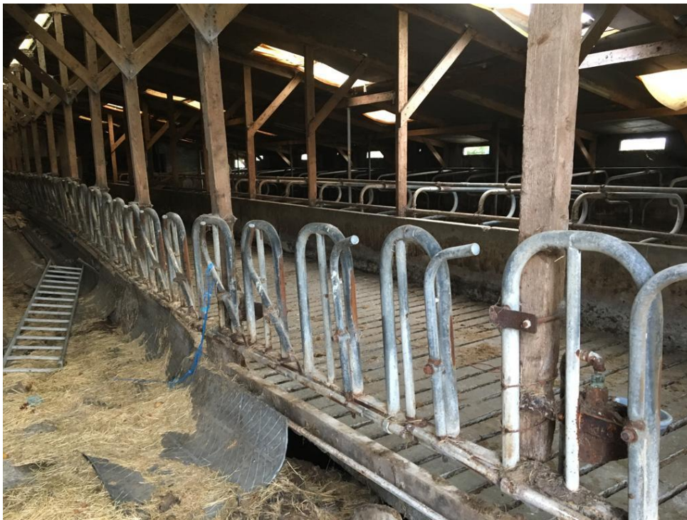
Afbeelding 3: Rundveeststal, verzakking stal in de kelder
