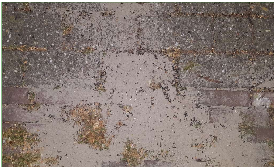
Vleermuisuitwerpselen onder een verblijf in de houten betimmering van het zwembadgebouw.
