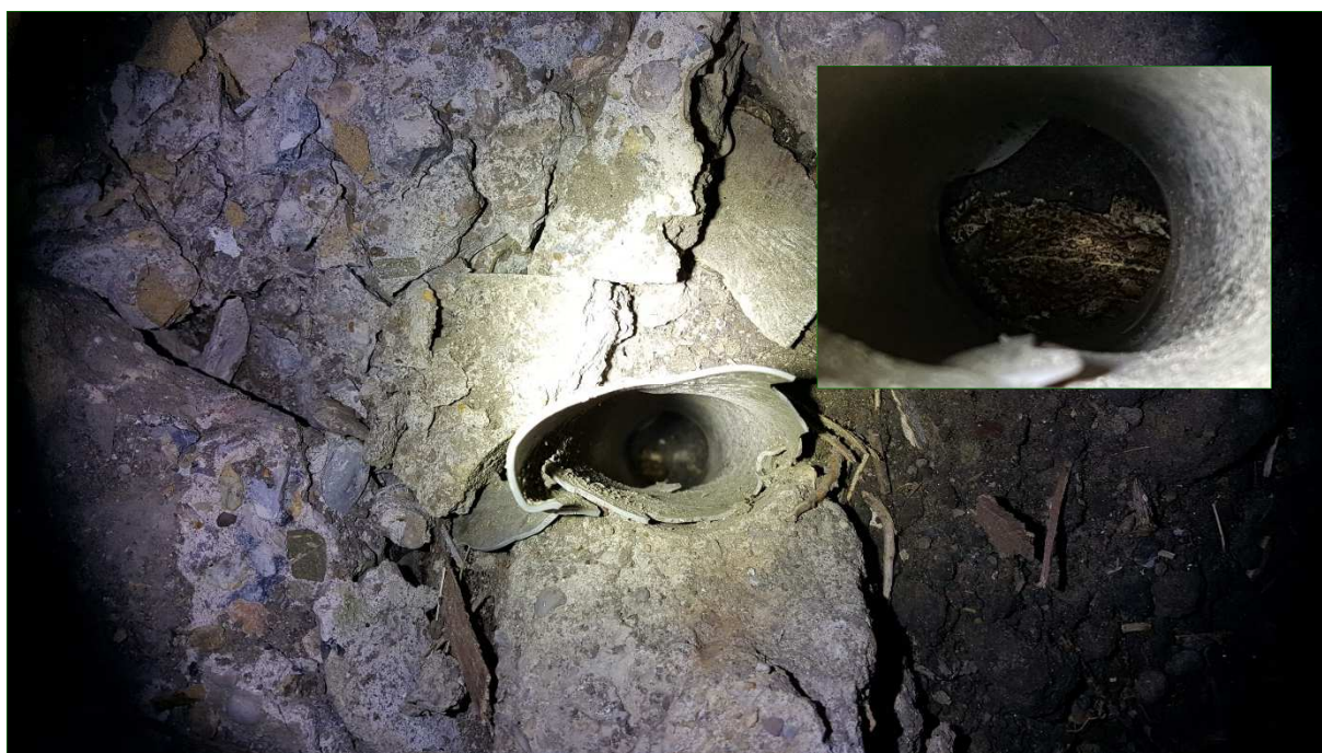
Rugstreeppad in ruimte onder betonnen fundering. Zichtbaar dankzij een afgebroken pijp die boven de grond uit stak.
