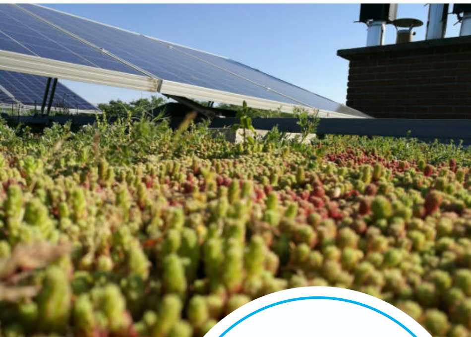
Groen dak met zonnepanelen
