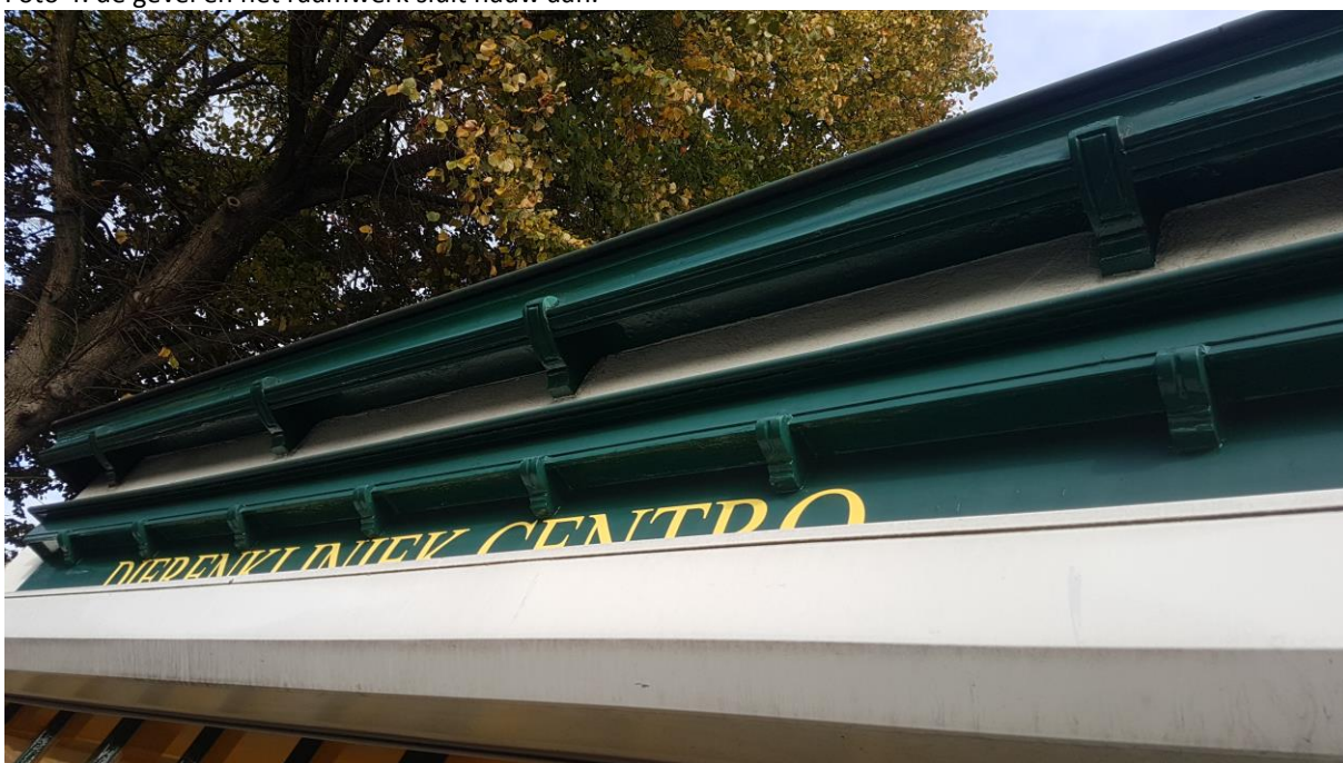
Foto 5: er is geen ruimte tussen de gevel en het houtwerk.
