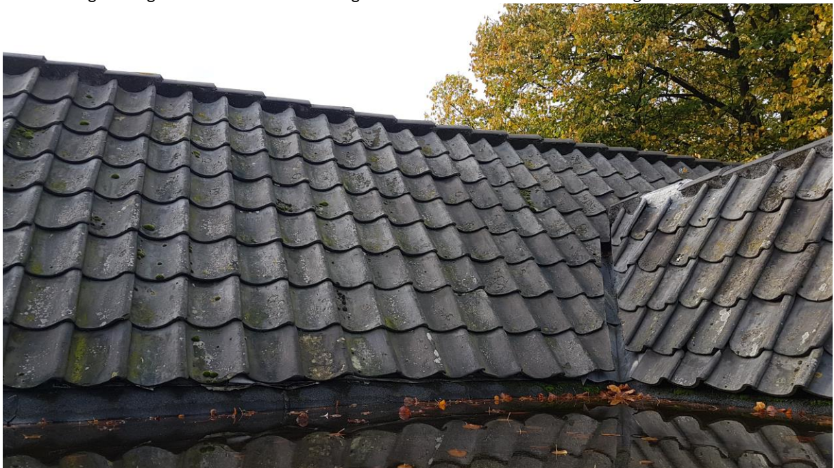
Foto 7: een deel van het platte dak. N.B. is rechts te zien dat de nok recent nog is gerepareerd.
