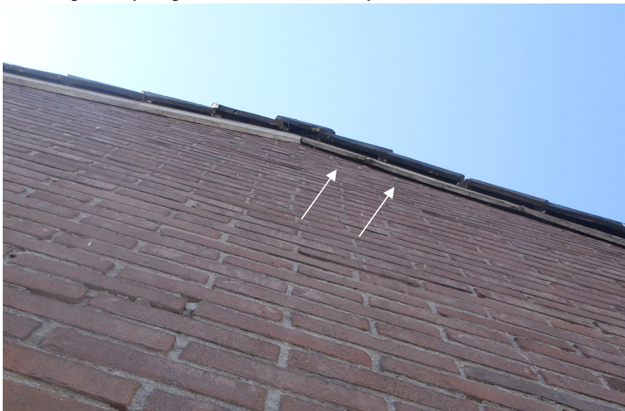
Afbeelding 9. De openingen in het dak onder de dakpannen en boeideel
