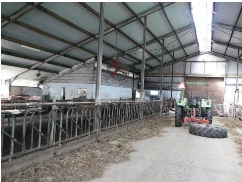
De oude ligboxenstal is voldoet wat maatvoering en ventilatie betreft niet meer voor melkkoeien
