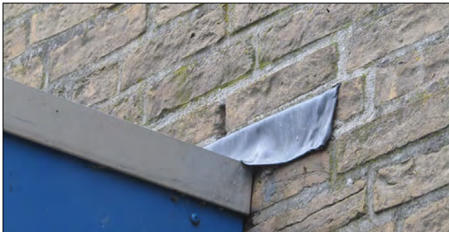
Figuur: de openingen bij het daklood en de stalen dakrand op het schoolgebouw zijn geschikt voor vleermuizen. Vleermuizen kunnen een verblijfplaats hebben onder het daklood en onder de stalen dakrand.
