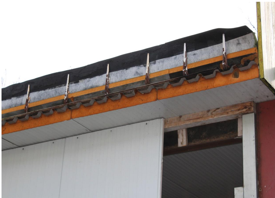
Figuur 6: In onder meer de dakrand zijn diverse openingen gevonden waardoor vleermuizen bij de spouw kunnen geraken.
