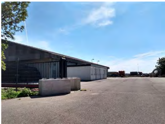
Afbeelding 11. Middendeel tracé, aan Rijnlanderweg (vlakbij Wasco). Verdachte dakbedekking.
