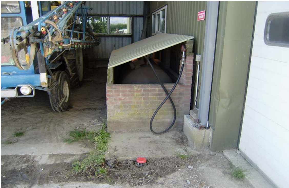
Foto 5: Gezicht vanuit noordoostzijde op de locatie van de bovengrondse olietank.
